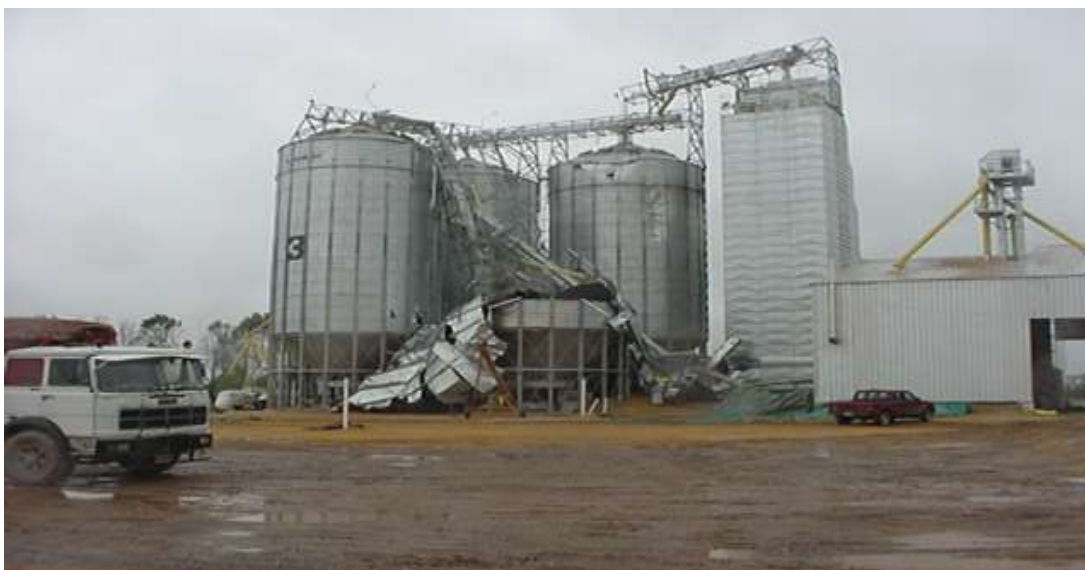
Vista general planta de silos, hs después de su desmoronamiento
